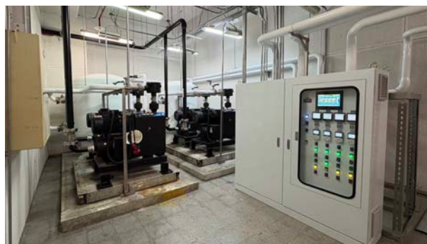
▲ 真空泵設備機組
