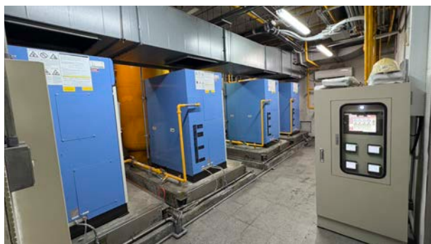
▲ 空壓機設備機組
